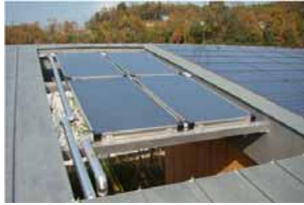
[그림 135] 태양열 급탕(Solar Thermal)
